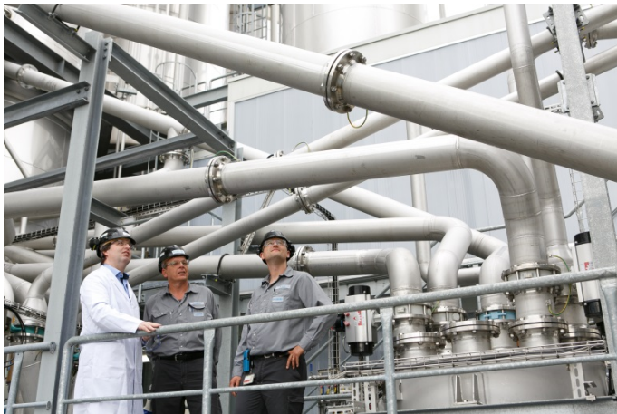
[Foto 3] Energiesparend ins Silo: Bei Kuraray arbeitet ein interdisziplinäres Team stetig daran, Anlagen und Prozesse an den Produktionsstandorten effizienter zu machen. Ein Beispiel ist eine bessere Vernetzung des Überdruckfördersystems im Industriepark Höchst, das die pulver- und granulatförmigen Materialien der Mowital- und Povalproduktion über Rohrleitungen zwischen den Prozessschritten und zum Zwischenlagern in Silos transportiert. Dank einer besseren Vernetzung der Kompressoren lässt sich der Energiebedarf signifikant reduzieren.
